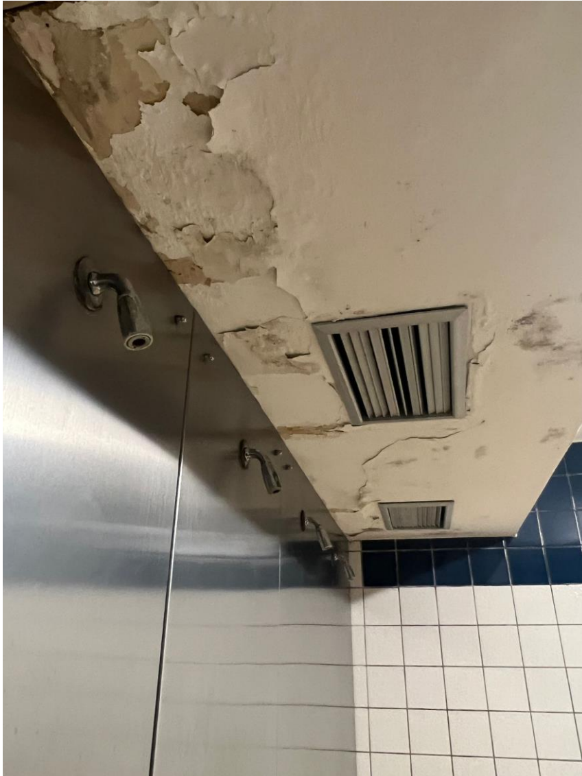
Abbildung 02: Duschen am städtischen Gymnasium - hier: Ablüftung
