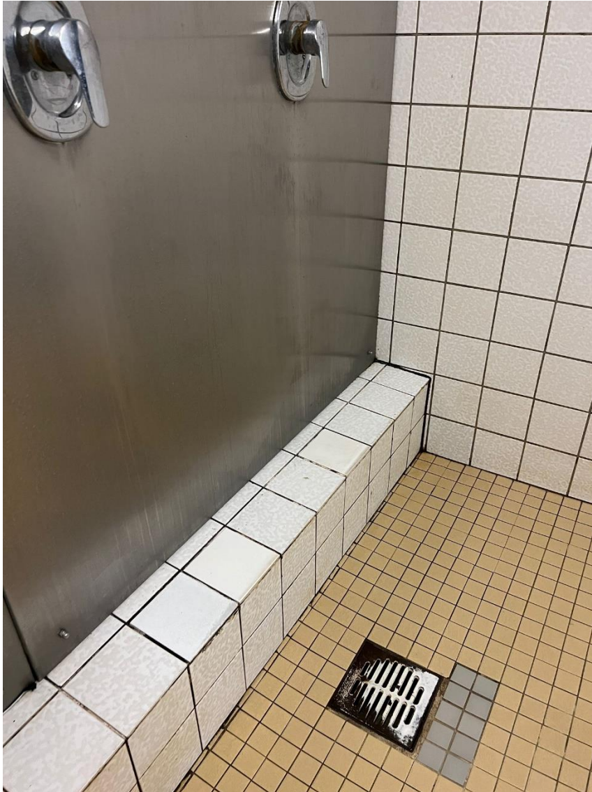
Abbildung 03: Duschen am städtischen Gymnasium - hier: Abflüsse
