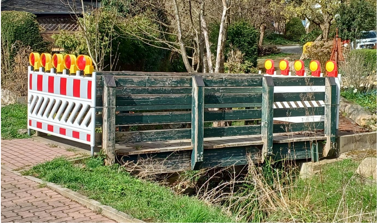
Abbildung 01: Gesperrte Brücke am Rubensweg / Übergang zum Niederweg
